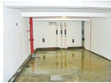
過去每逢大雨，愛民邨地下3個樓層經常會出現滲水，甚至出現圖中大量積水的情況。（房屋署提供）
