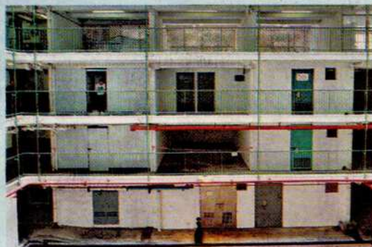
■愛民邨雙塔式公屋的地下三層有不少「空格」，過去經常受地下水滲水問題困擾。
